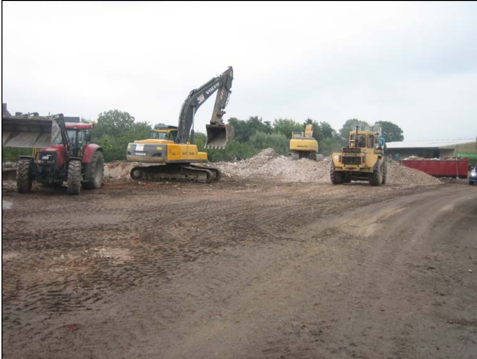
Abbildung 3: Blick auf den nördlichen Teil des Plangebietes - Abriss des Gebäudes der ehemaligen Molkerei.
